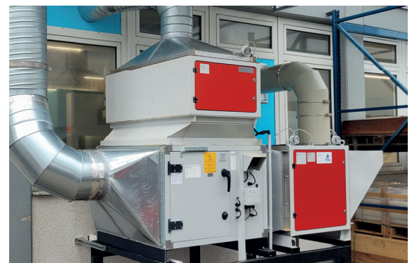
Abluftreinigung mit direkter Wärmerückgewinnung
